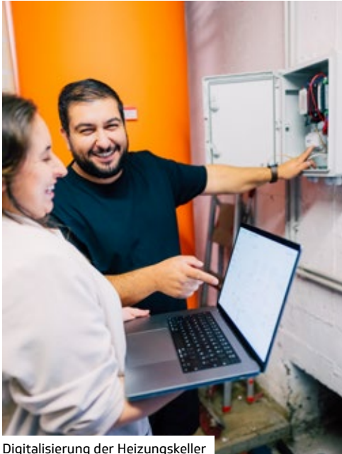
Digitalisierung der Heizungskeller
