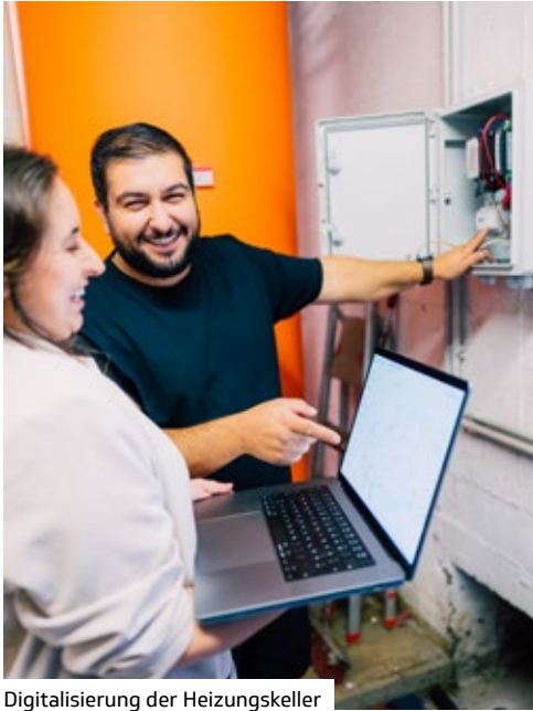
Digitalisierung der Heizungskeller
