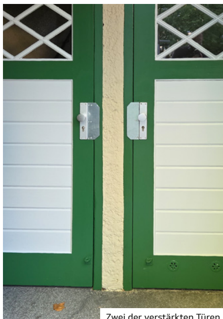
Zwei der verstärkten Türen.
