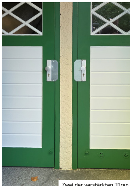
Zwei der verstärkten Türen.
